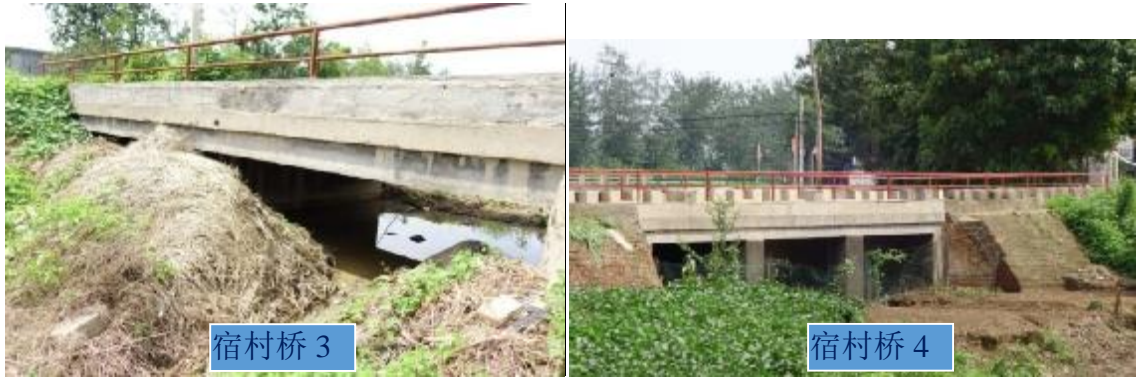
图 4-35 栾城段宿村桥 3 和宿村桥 4 现状图，河道束窄，阻水严重（宿村桥 3 增加桥孔，宿村桥 4 拆除重建）
