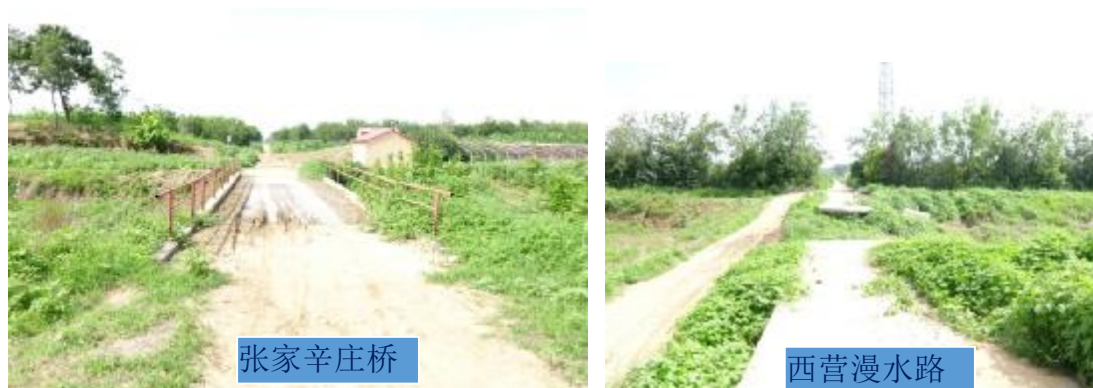
图 4-31 栾城段张家辛庄桥和西营漫水路现状图，阻水严重，西营漫水路被冲毁，堤防位置存在缺口（拆除重建桥梁）
