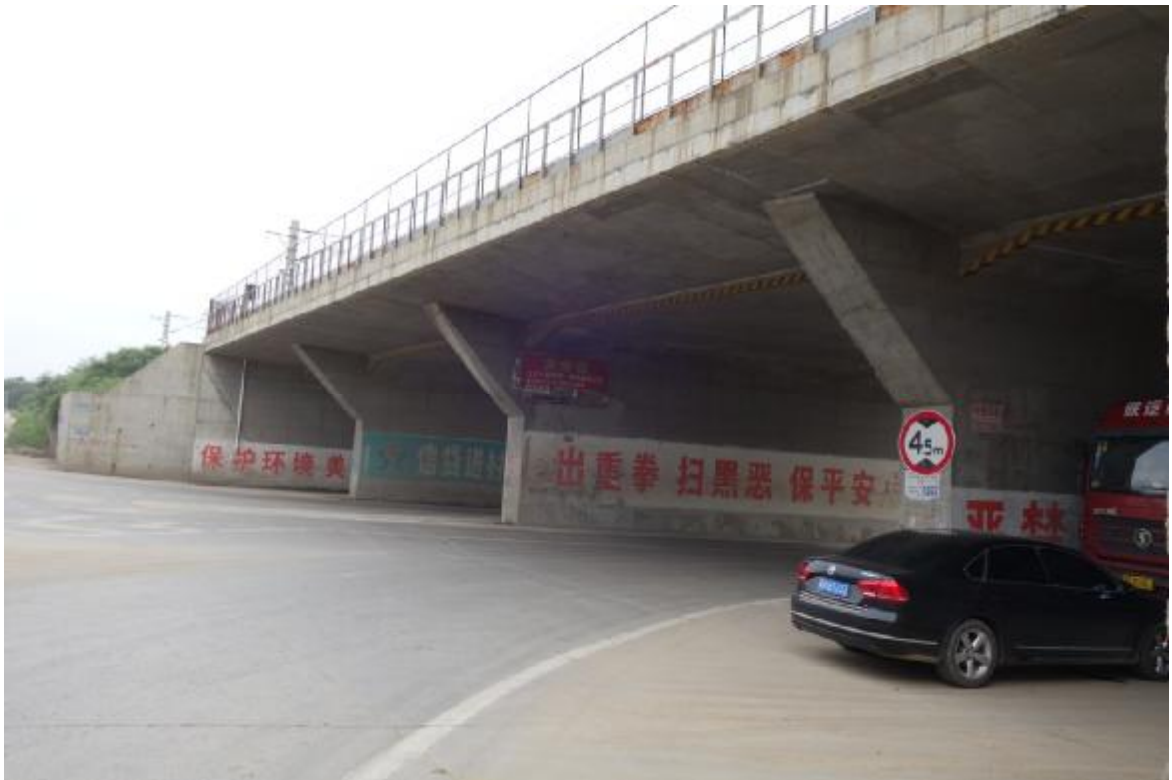
图 4-16 京广铁路西侧潞龙河与 427 乡道、G107 交汇处（缺口位置，X14+900） 图为 107 国道桥
