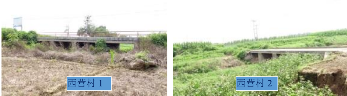
图 4-32 栾城段西营村桥 1 和西营村桥 2 现状图，阻水严重，筑堤处存在缺口（增加桥孔）
