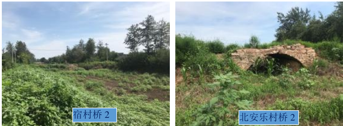
图 4-34 栾城段宿村桥 2 和北安乐村桥 2 现状图，河道束窄，阻水严重，废弃（拆除）
