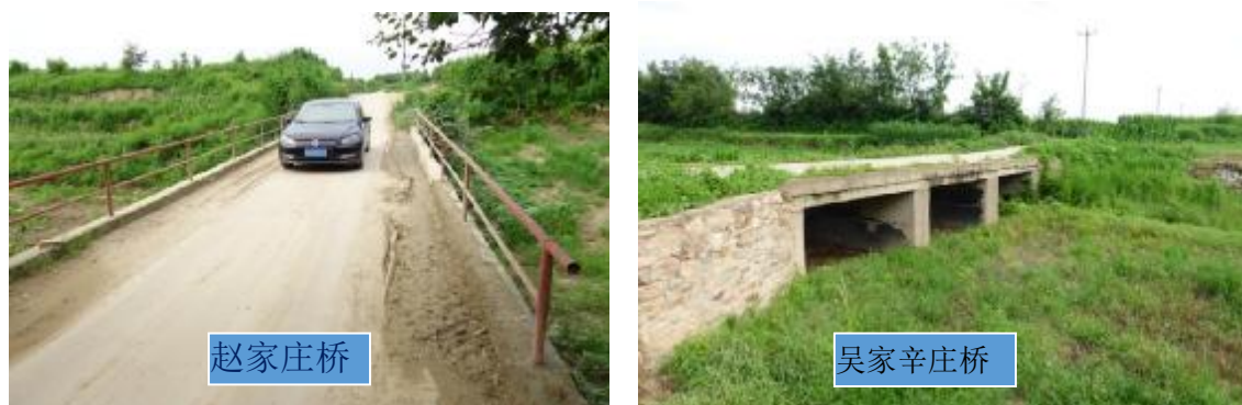
图 4-30 栾城段赵庄村桥和吴家辛庄桥现状图，阻水严重，堤防位置存在缺口（拆除重建）
