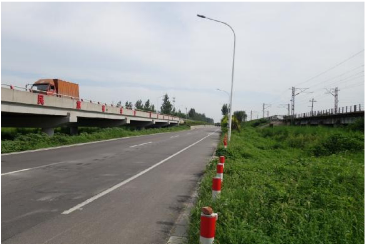
图 4-18 潞龙河穿过京广铁路位置 (X16+400), G107 引道漫水路缺口
