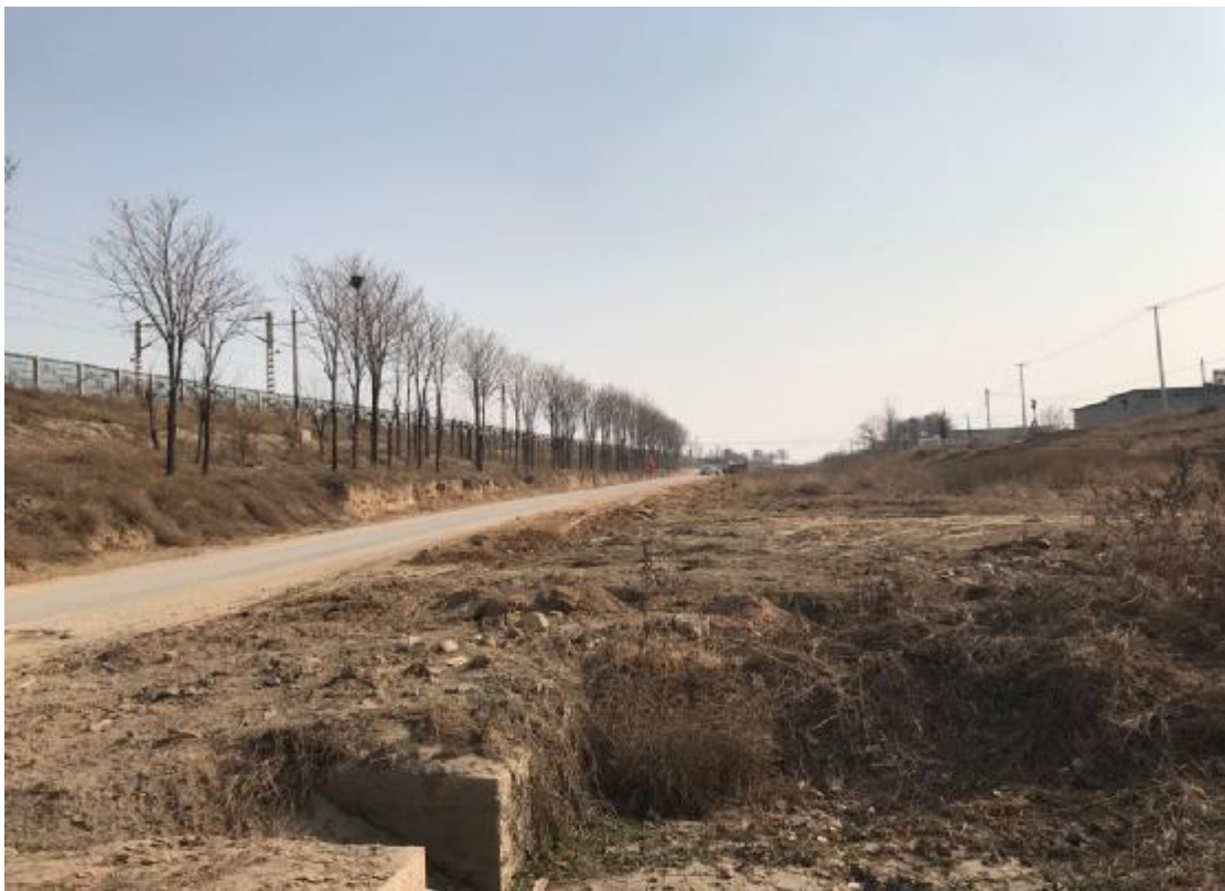
图 4-14 京广铁路段潞龙河河道, 河道左岸未防护的岸坡
