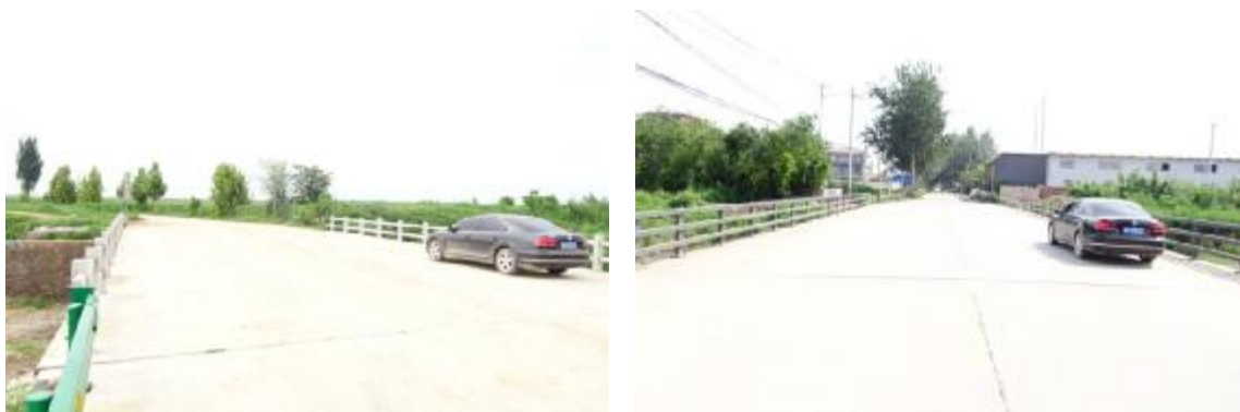
图 4-37 当铺庄桥（县界）和栾城段 X017 县道现状图，筑堤处存在缺口（洪水发生时临时封堵）
