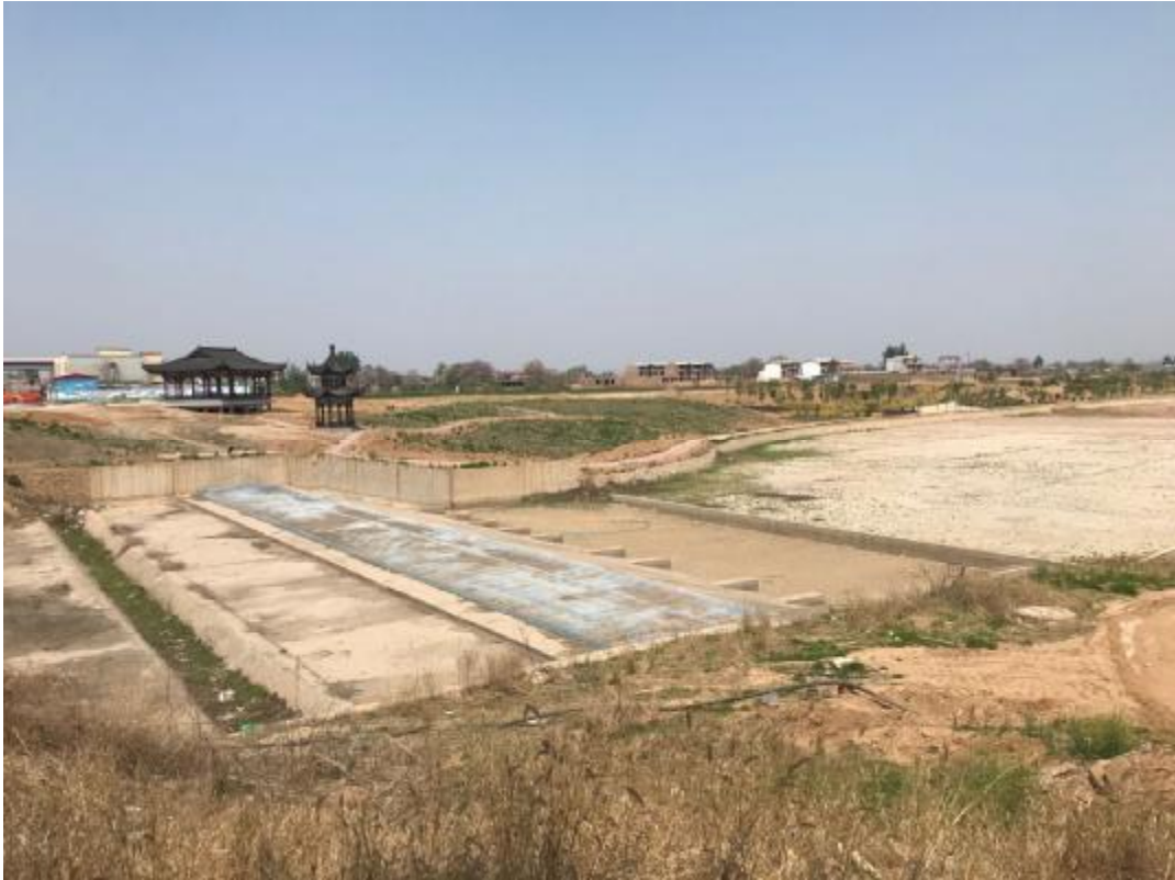
图 4-11 毛遗桥下游（龙河新区）已治理河段（X10+080），毛遗村橡胶坝
