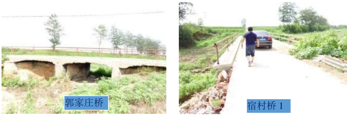
图 4-33 栾城段郭家庄桥 1 和宿村桥 1 现状图，阻水严重，筑堤处存在缺口（郭家庄桥拆除重建，宿村桥 1 增加桥孔）
